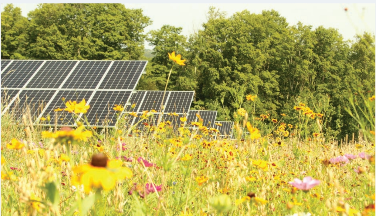
Parc solaire en fleurs ©ENGIE Distributed solar, North America
